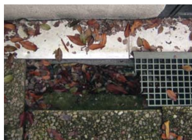
égout à nettoyer
