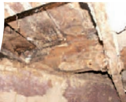
Humidité et condensation sur un solivage de cave
